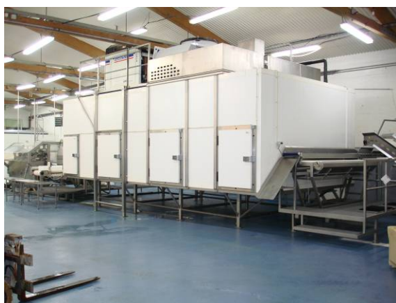
Figur 8. Skinnkjøleren sett fra innmatingsenden og fremover langs ene siden. Trykkvanns- og kuldeanlegg på taket av kjøleren.
