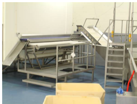
Figur 9. Transportbånd mellom filetkjøler og skinnkjøler. Legg merke til den lille bordplaten på innmatingsplattformen som kan brukes til grovtrimming av enkelte fileter.
