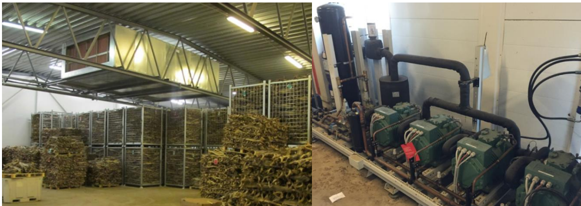
Figur 6 Klimalager med aggregat i tak (t.v.) og kompressor kuldesystem (t.h.)
